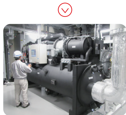
更新した電気式冷凍機
