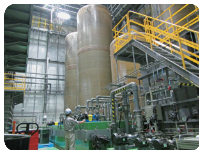
環境を考慮した屋内型排水貯槽
